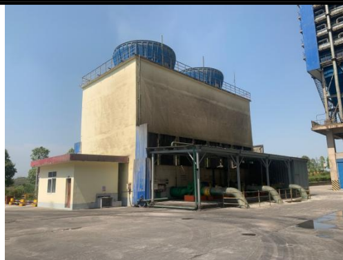
循环泵房及冷却塔
