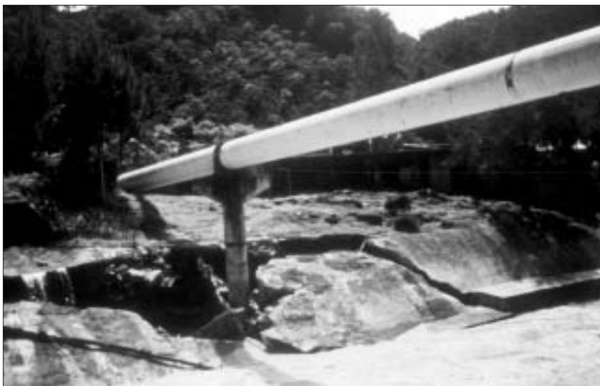
Daños provocados en protecciones de puente para paso de tubería de línea de conducción Oroquieta, Costa Rica, octubre 1999. Concreto desplazado: peso 500 toneladas.
