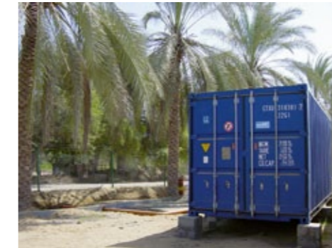
Container für Wasseraufbereitung im Oman
