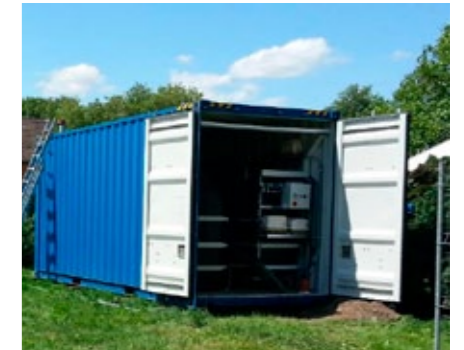
Containerlösung: Wasser und Kälte
