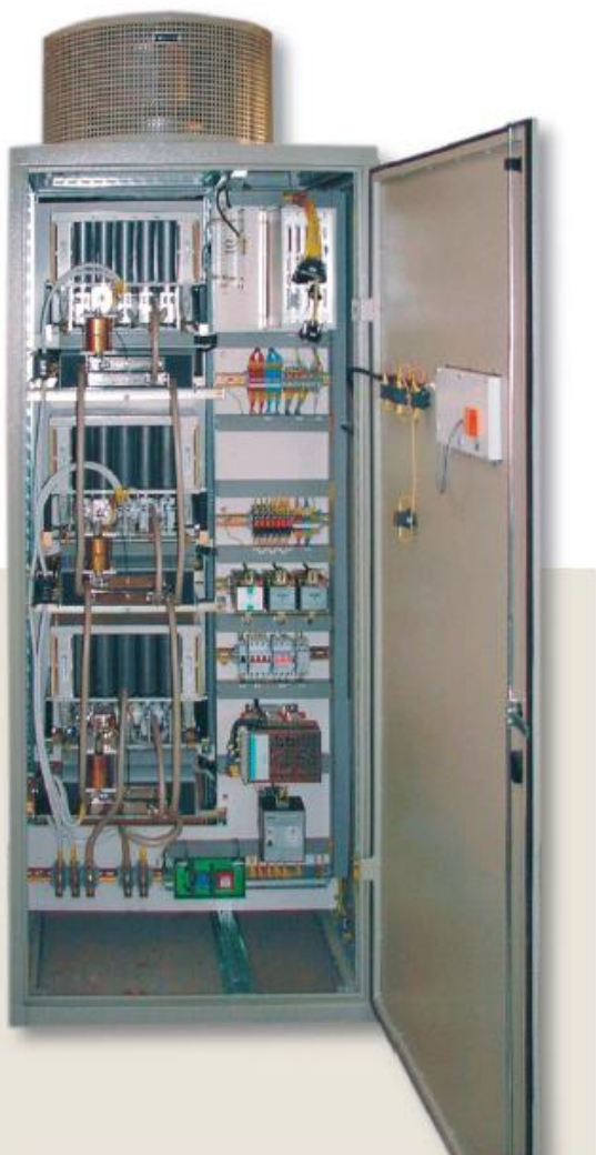
Měnič INVERT s IGCT tyristory
