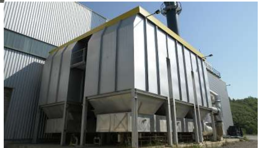
Regeneracyjno – Termiczne - Utlenianie RTO
