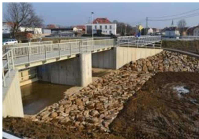
Nové ochranné uzavírací zařízení na Baťově kanálu
