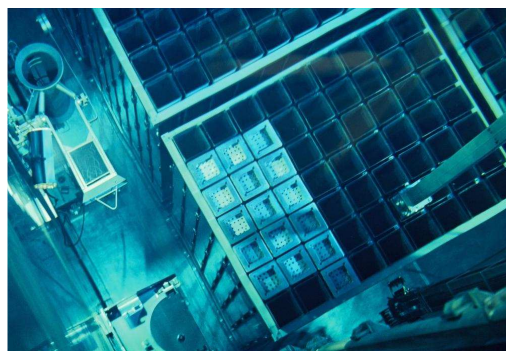
Piscine de refroidissement (EDF Belleville)
