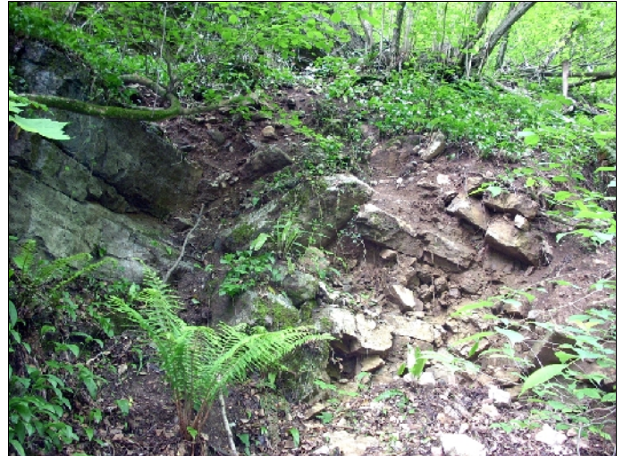
Fig. 11: nicchia della piccola frana appena a nord dell'affioramento di Calcere di Moltrasio. Si nota il substrato molto disarticolato affiorante.
