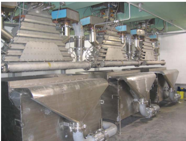
Rys. 3. Widok urządzeń wyjściowych akceleratora ELV 12 pracującego w instalacji do oczyszczania ścieków przemysłowych
