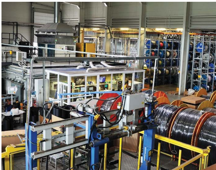
Rys. 5. Widok hali technologicznej i sterowni akceleratora IŁU 10 w firmie RADPOL S.A. z Człuchowa produkującej w skali masowej rury i mufy termokurczliwe modyfikowane radiacyjnie
