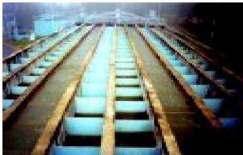
Figura 3-21. Floculadores de pantallas de flujo vertical (7)
