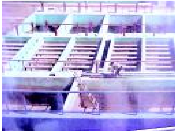
Figura 3-3. Floculador de pantallas después del sismo (7)
