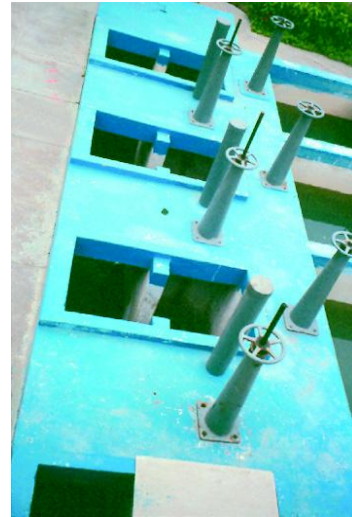
Figura 5-29. Canales de agua filtrada destapados
