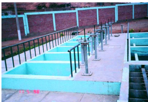
Figura 5-1. Batería de filtros de tasa declinante y lavado mutuo (1)
