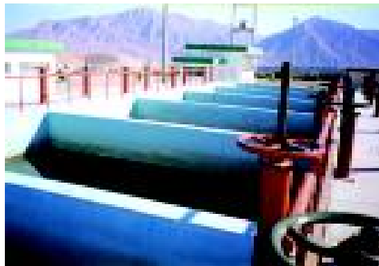
Figura 5-30. Batería de filtros de tasa declinante para un caudal de 250 L/s
