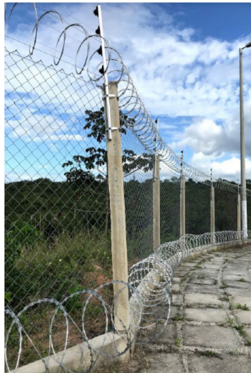
Figura 59 Instalação de 600 metros de cercas concertina dupla na parte inferior e 600 metros de concertina simples na parte superior protegendo todo o perímetro, além de 600 metros de cerca elétrica em toda a extensão do alambrado.
