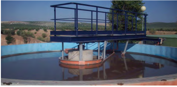
Estación depuradora de aguas residuales
