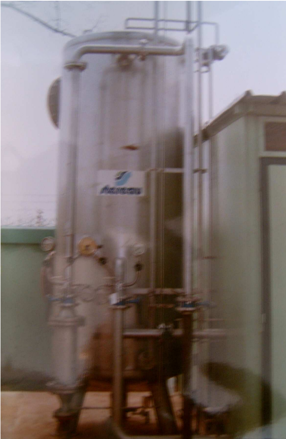
Fig. 118. Photo du poste de déferrisation et démantanisation de ZUENOULA, Côte d'Ivoire.
