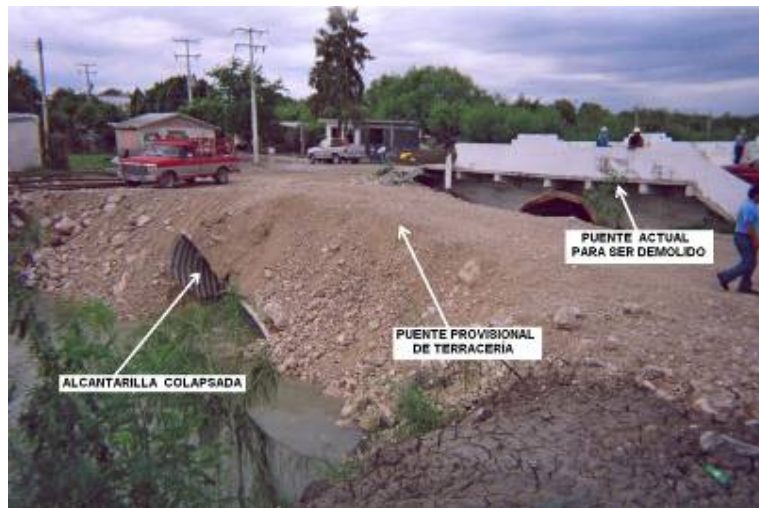
Figura 2.184 Puente provisional. Alcantarilla colapsada
