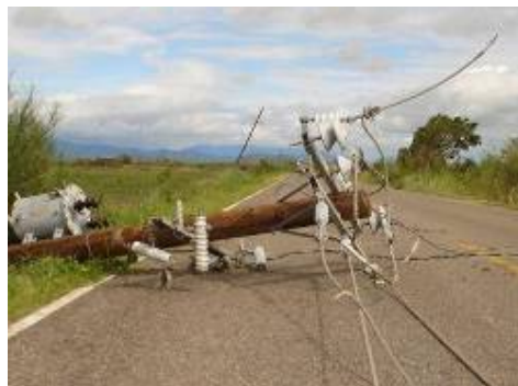
Figura 2.134 Daños en postes para cableado eléctrico que obstaculizaron las vialidades
