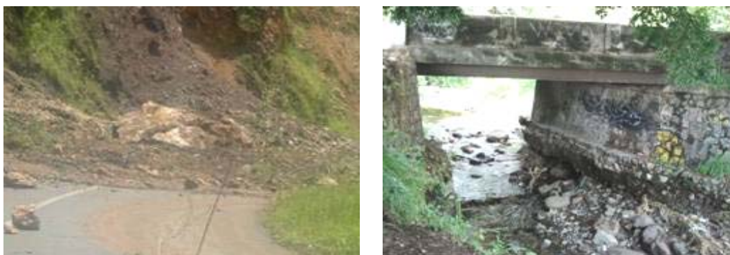
Figura 2.154 Daños en caminos y puentes del municipio de Villa de Álvarez
