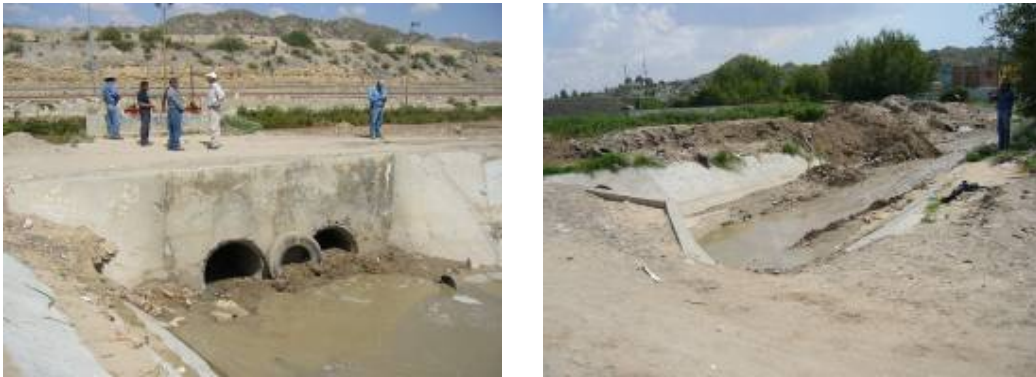
Figura 2.33 Una de las compuertas para descargar los escurrimientos que bajan de la sierra
