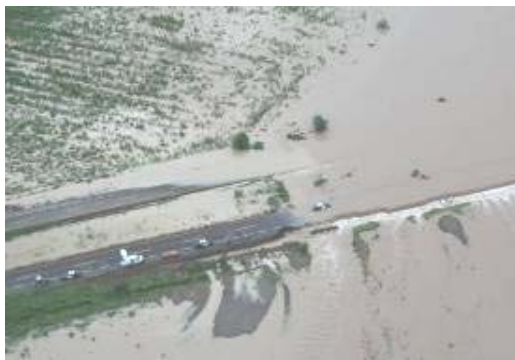
A. Inundaciones sobre la carpeta asfáltica de la maxipista en el kilómetro 162. El agua permaneció durante dos días
