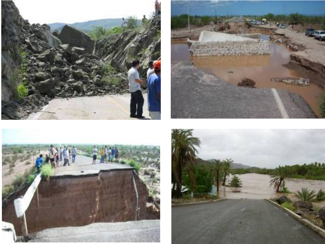
Figura 2.80 Principales afectaciones en la infraestructura carretera federal
