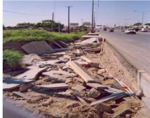
Figura 2.178 Erosión en una de las banquetas del libramiento a Monterrey
