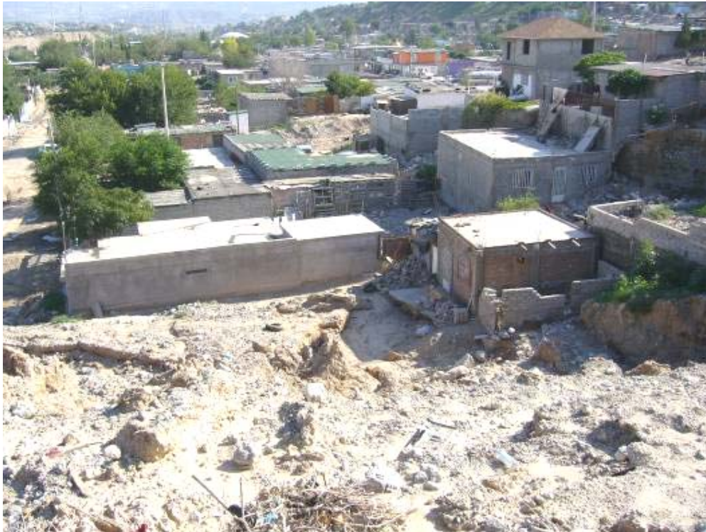
Figura 2.18 Talud aguas abajo del dique La Fronteriza. Nótese la erosión sobre el talud de aguas abajo y las viviendas al pie del mismo
