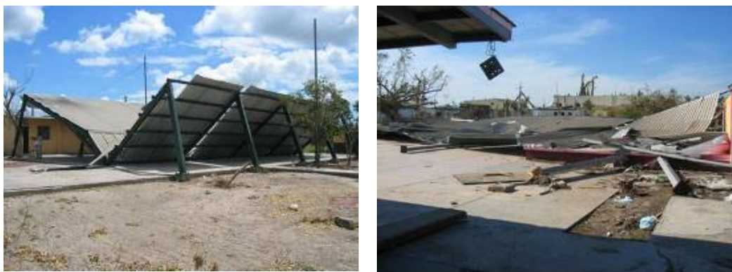
Figura 2.130 Daños en escuelas de nivel básico del municipio de Culiacán
