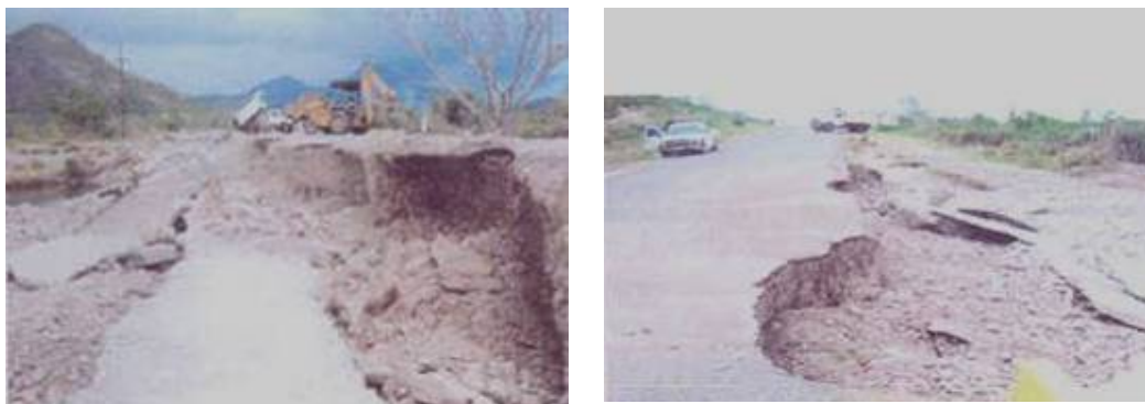
Figura 2.136 Daños en caminos a cargo del estado en el municipio de Culiacán
