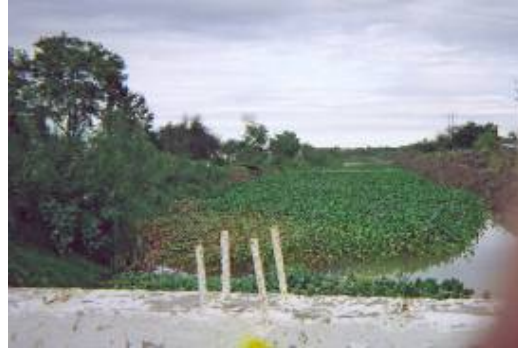
Figura 2.181 Exceso de lirio que afecta la capacidad del dren Río Bravo
