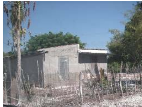
B. Vivienda afectada por las inundaciones en el poblado de Macario Glaxiola
