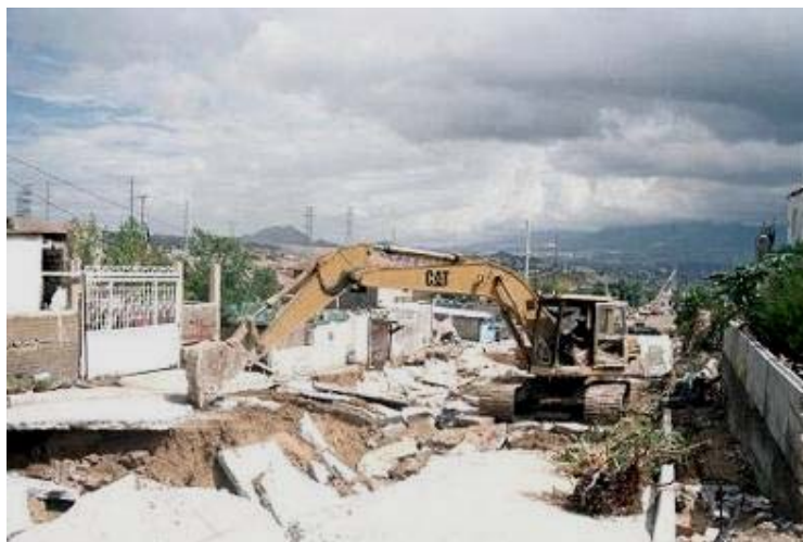
Figura 2.47 Calle afectada a causa de las lluvias
