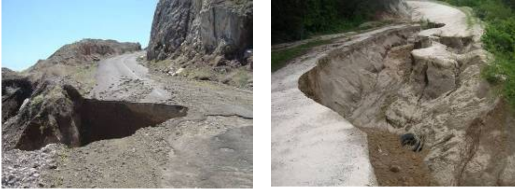
Figura 2.81 Daños en caminos rurales y alimentadores
