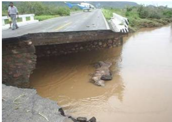
Figura 2.138 Daño en el puente “Las Flores” de la carretera federal Mazatlán-Culiacán, como consecuencia del huracán Lane
