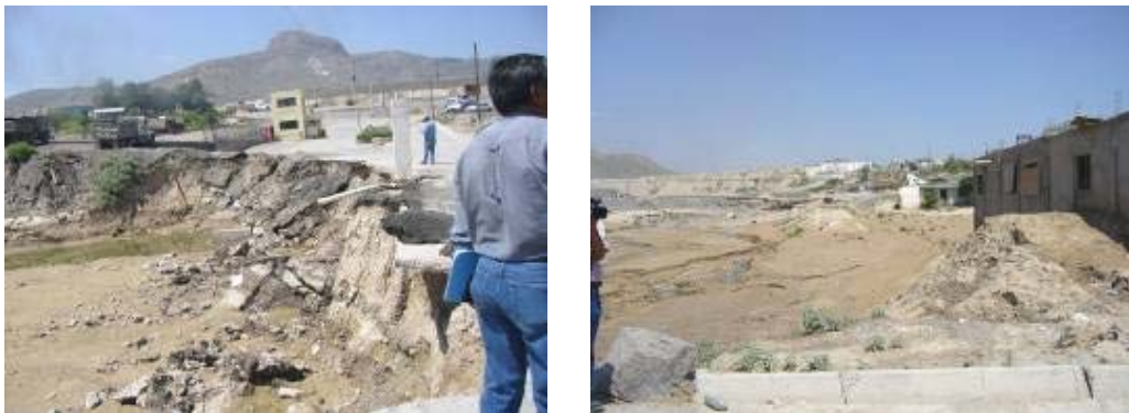
Figura 2.23 Dique La Trituradora. Daños a la entrada al vaso
