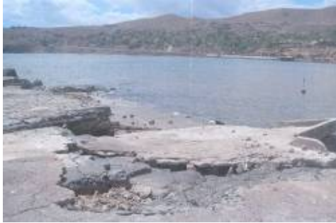
Daños en muelle
