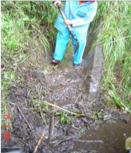
Figura 5.6 Limpieza de los drenes obstruidos arriba de la escarpa de falla del deslizamiento en el km. 32.5
