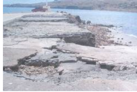
Daños en espigón de protección
