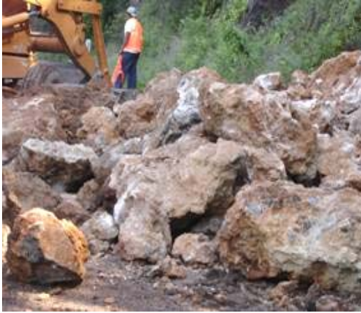
Figura 2.152 Derrumbe en infraestructura carretera
