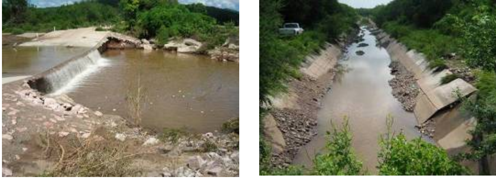
Figura 2.131 Daños en infraestructura hidroagrícola
