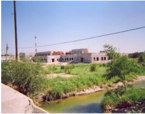
Figura 2.177 Hospital en construcción que sufrió inundaciones
