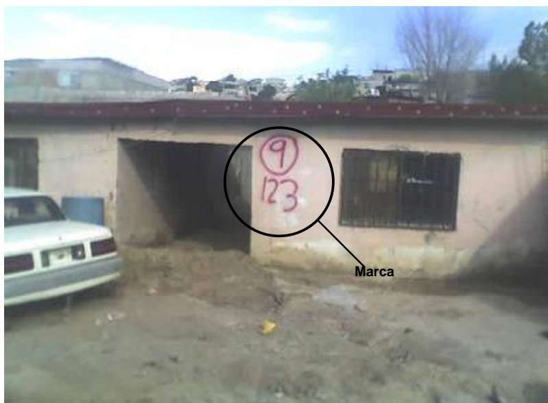
Figura 2.41 Vivienda con marca para reubicación de sus ocupantes y sujeta a demolición en la colonia Fronteriza Baja
