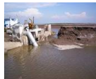
Daños en bordos y equipo de bombeo de las unidades acuícolas
