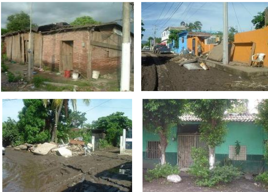
Figura 2.149 Afectaciones de diversos grados en viviendas de Colima
