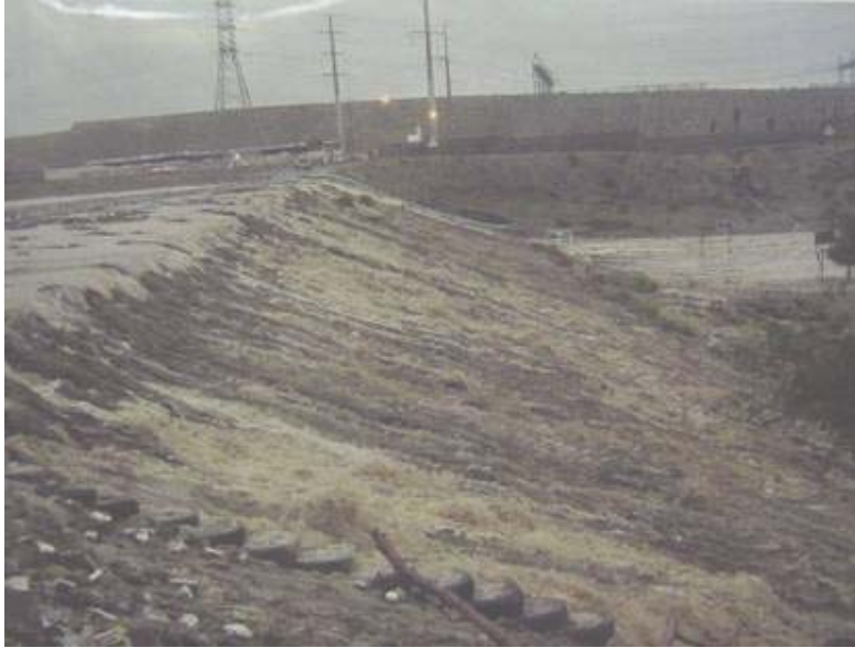
Figura 2.22 Momento en que se desborda el dique La Fronteriza
