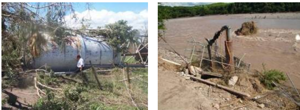
Figura 2.133 Daños en infraestructura hidráulica
