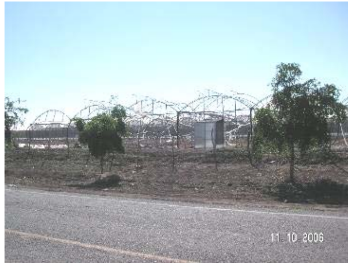
Figura 2.119 Pérdida de techos debido a los fuertes vientos producidos por la depresión tropical Paul en el municipio de Navolato
