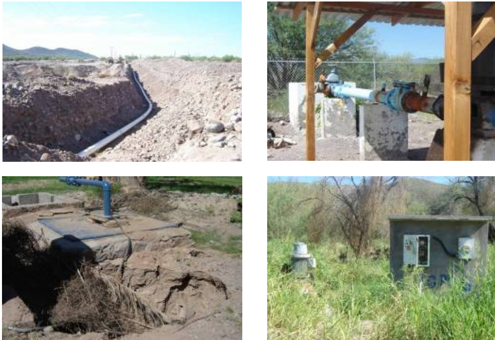
Figura 2.77 Principales daños en la infraestructura hidráulica
