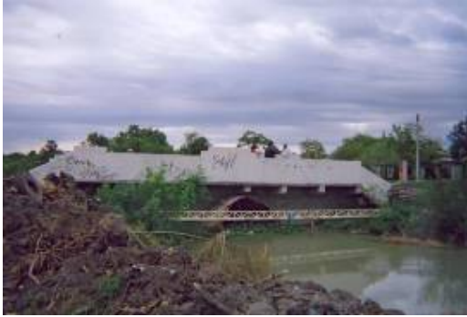
Figura 2.180 Alcantarilla circular que limita la capacidad del dren Río Bravo
