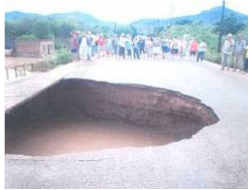
Figura 2.139 Daños en carreteras en el municipio de Mocorito como consecuencia del huracán Paul
