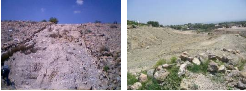
Figura 2.24 Dique La Trituradora. Daños en la cortina y el vertedor
