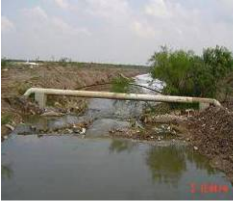
Figura 2.197 Dren El Anhelito, municipio de Reynosa afectado por la acumulación de basura
