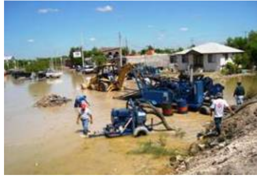
Figura 2.174 Bombas usadas durante la emergencia
