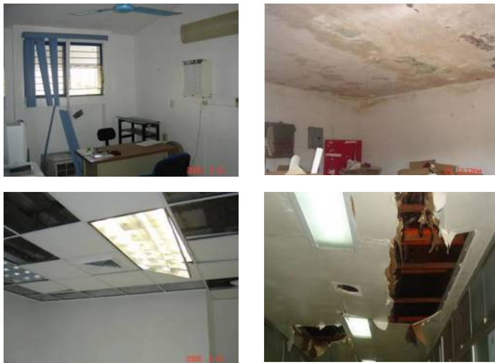
Figura 2.128 Principales daños en infraestructura de salud
