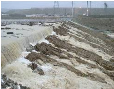
Figura 2.44 Desbordamiento del dique La Montada
