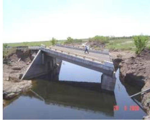
B. Puente colapsado en el km 129 de la Maxipista
