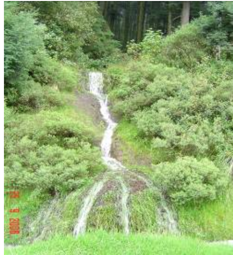
Figura 5.7 Debido a que las contracunetas se encontraban obstruidas, el agua de lluvia escurría por el terreno natural, y no por los lavaderos que se construyen para ello
