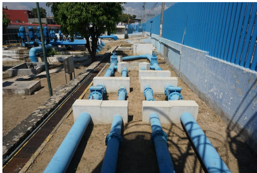
Figura VI.3 Conexiones con la tubería principal
