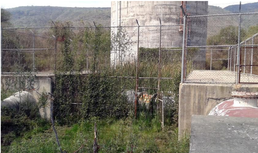
Figura I.12 Tanque unidireccional de 18 m de altura y 18 m de diámetro (Acueducto Chapala-Guadalajara)
