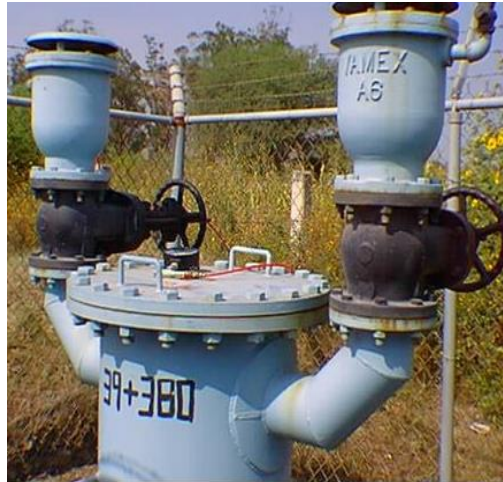
Figura I.14 Válvula de admisión y expulsión de aire (del acueducto Chapala Guadalajara)
