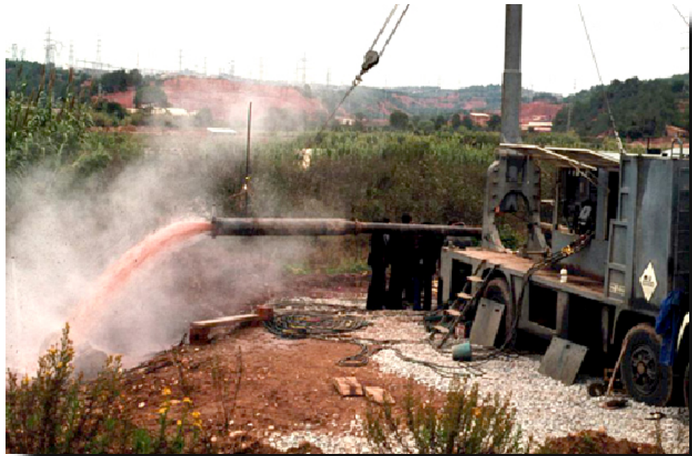
Ensayos de producción de energía geotérmica de baja entalpía en el Vallés (Barcelona) en 1974
