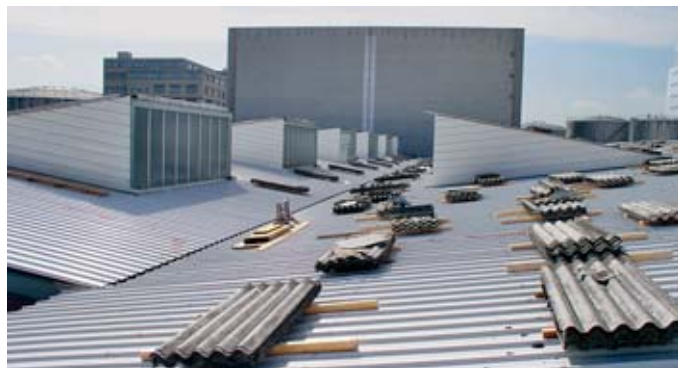
Lastre ondulate contenenti amianto
