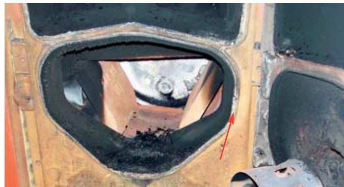
Cordone di amianto
