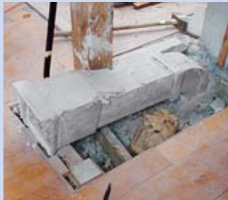
Canale di ventilazione in fibrocemento
