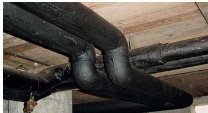
Guaina bituminosa contenente amianto
