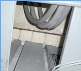
Barriera antifiama con cuscini di amianto
