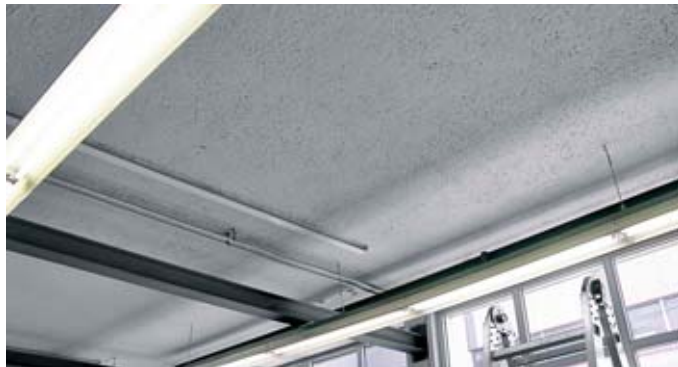
Rivestimento del soffitto in amianto spruzzato
