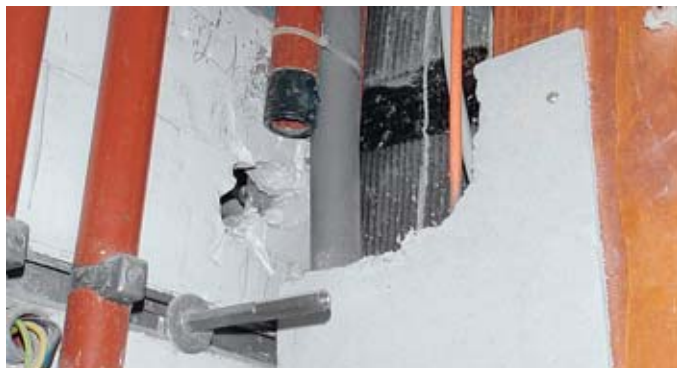
Pannello antincendio in colonna montante
