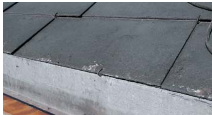
Pannelli di ardesia contenenti amianto
