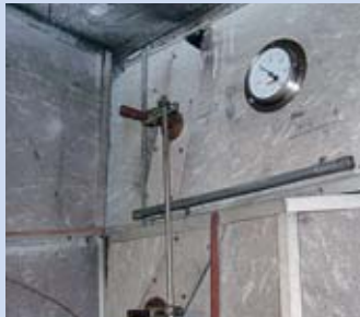
Impianto di ventilazione in fibrocemento
