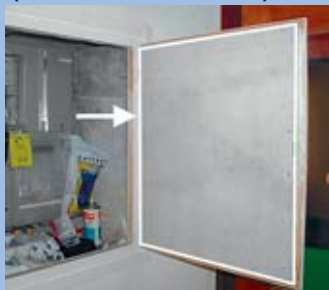
Pannello antincendio contenente amianto
