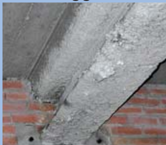
Isolamento in amianto spruzzato
