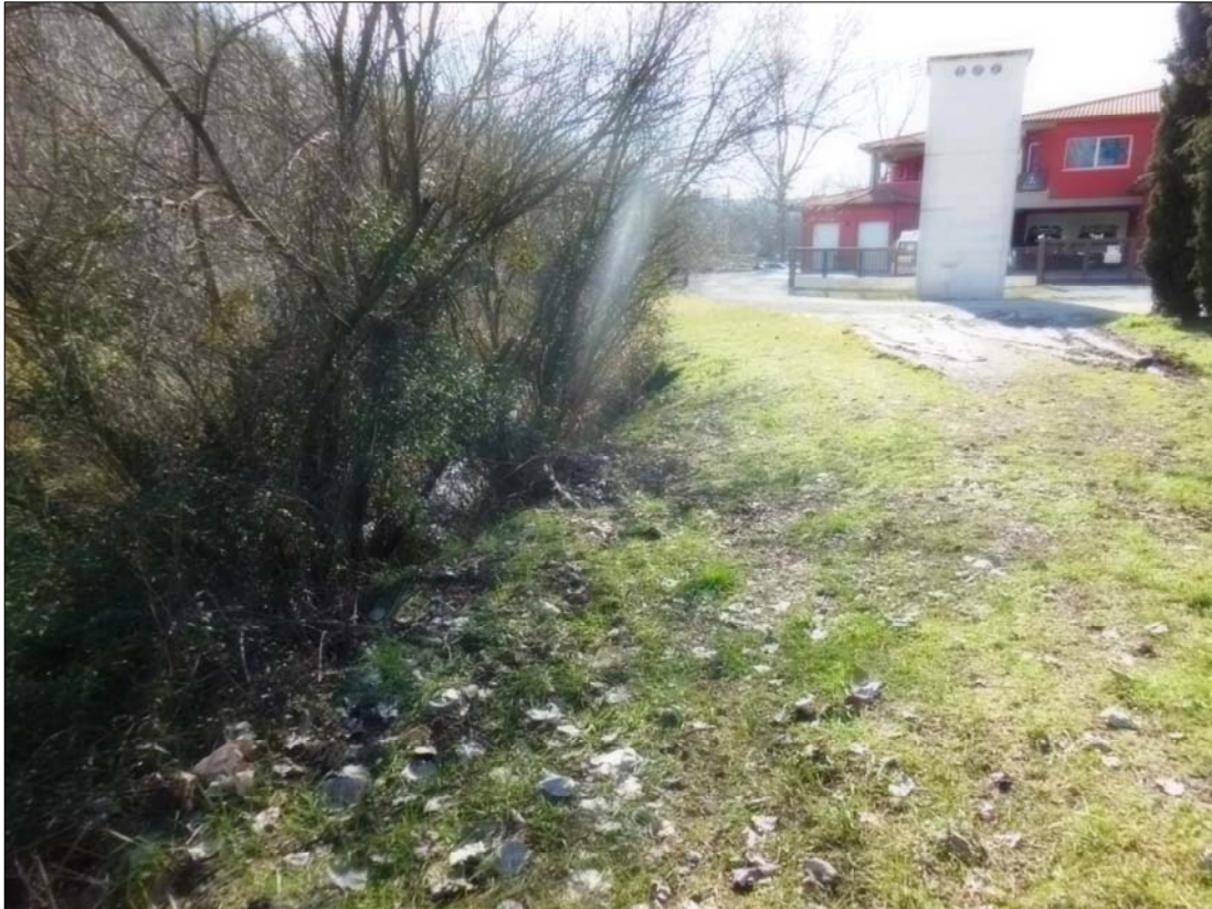
FIGURA 3-1: MOVIMENTO FRANOSO IN DESTRA IDRAULICA
