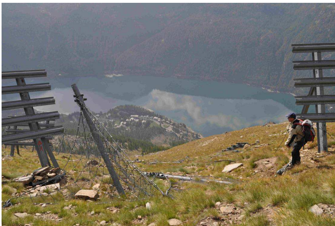
Immagine 2 : particolare barriere abbattute, scalzamento fondazione sx, rotazione elem..
