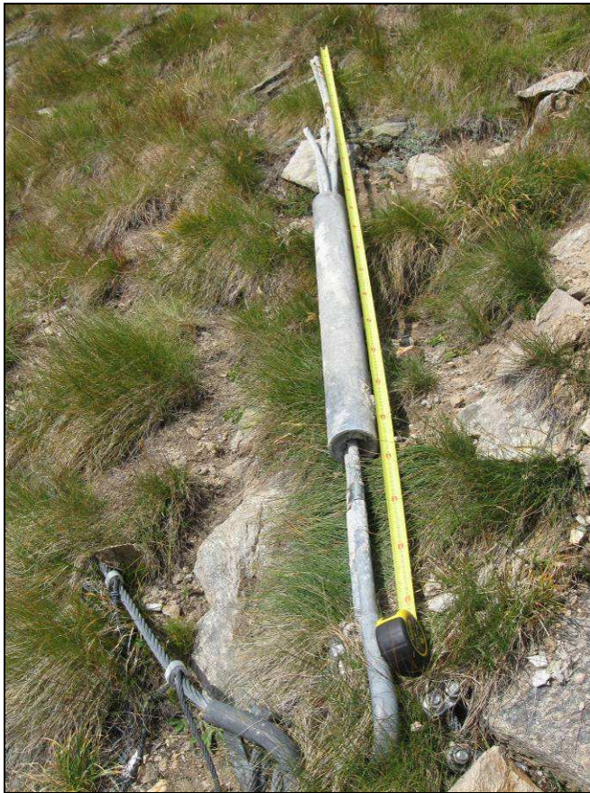
Immagine 6 : ancoraggio di monte Fila 8 completamente estruso
