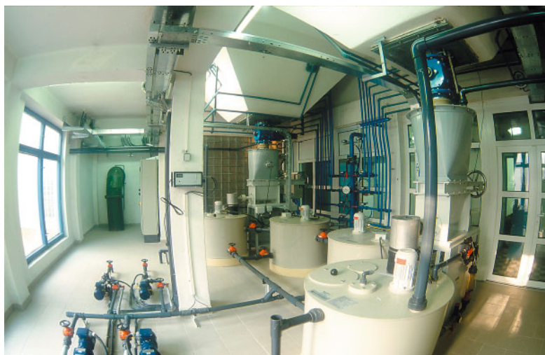
Úpravna vody Troubky – dávkování vápna.
