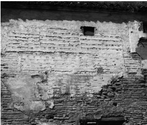
Figura 10 Restos edificio nobiliario. Guadix
