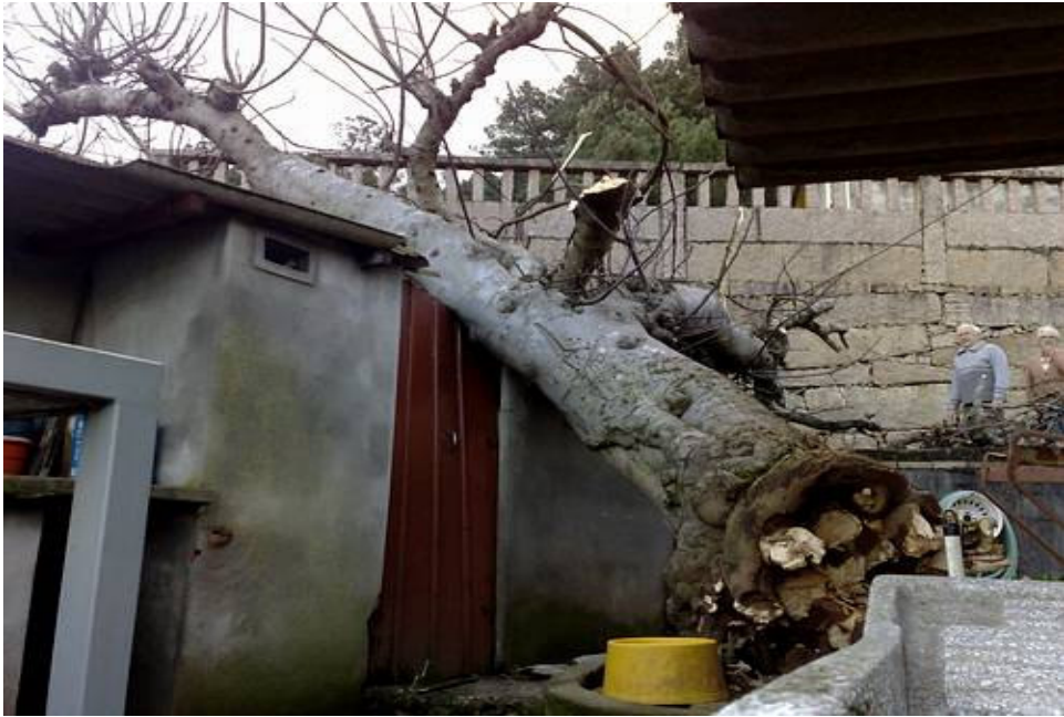
Imagen 2.- Daños tormenta Klaus
