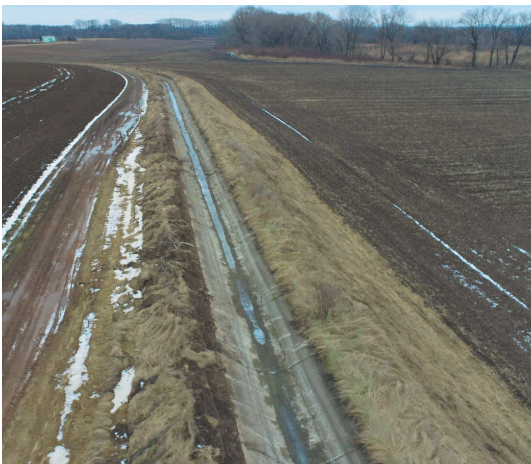
Obr. 10. Aktuální stav kanálu po provedení pravidelného čištění. (Foto: VÚV).
