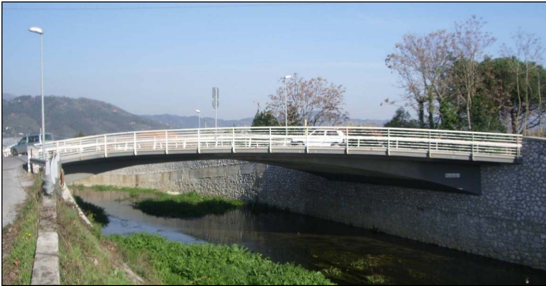
Figura 5-18: Fotografia del ponte sul fiume Camaiole ove è collocata la stazione di monitoraggio del trasporto solido.
