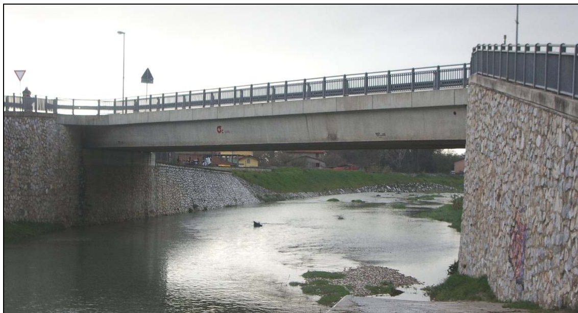
Figura 5-10: Fotografia del ponte sul fiume Versilia ove è collocata la stazione di monitoraggio del trasporto solido.
