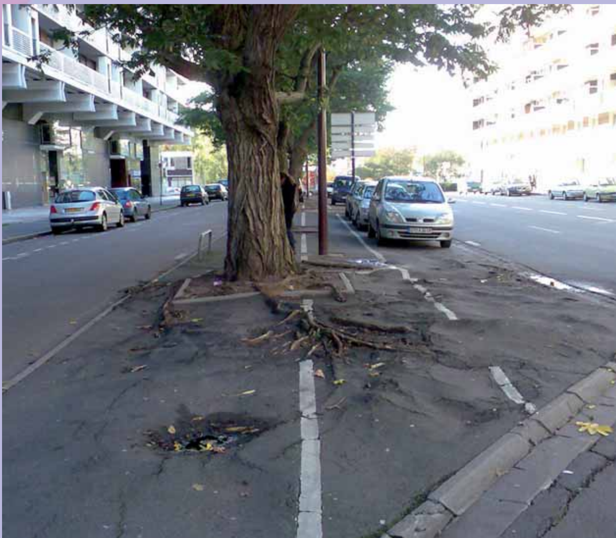
Pterocarya fraxinifolia che ha danneggiato la pavimentazione stradale
