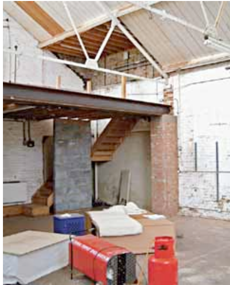
Εικόνα 38: Εδώ παρουσιάζεται ένα πάντρεμα των νέων διαρθρωτικών ένθετων με την υπάρχουσα κτιριακή δομή. Ένα τέτοιο σημείο στην εικόνα είναι η αναλλοίωτη διατήρηση της κολόνας με το τούβλο ενώ επάνω σε αυτήν στηρίζεται το νέο πατάρι με νέα και σύγχρονα υλικά.
