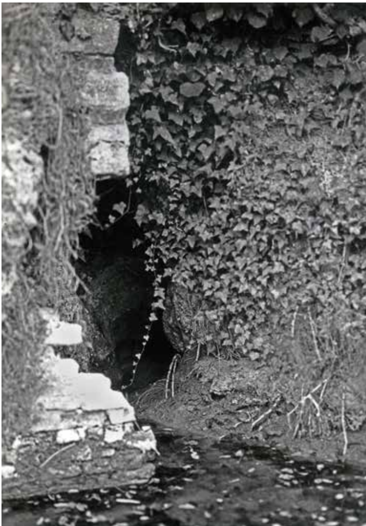
207 (in alto) - La Fonte Redolandella di Villa Bastia a S. Ruffillo. Foto L. Fantini - Archivio Storico GSB-USB.
