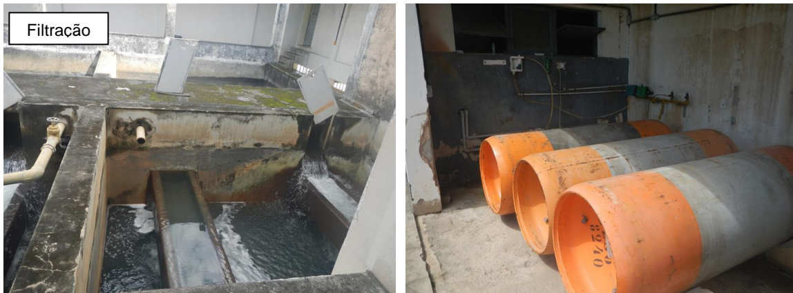
Figura 95: Estação de Tratamento de Água do Sistema Integrado Propriá. Fonte: Gesois, 2014.
