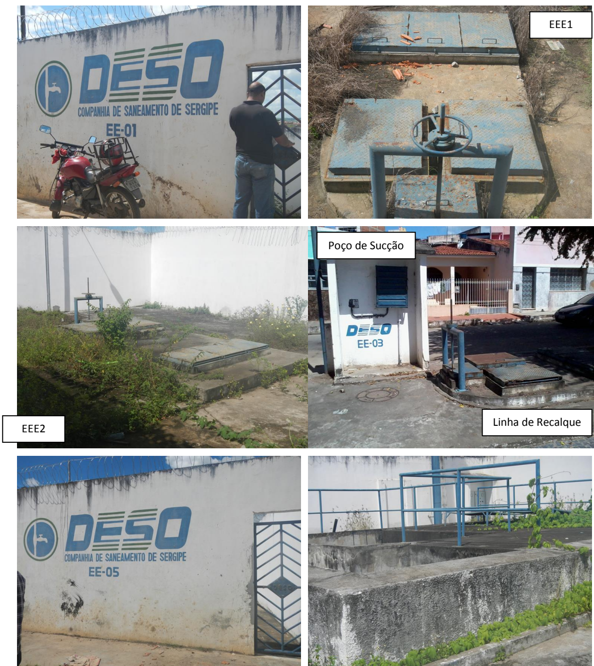
Figura 108: Estações Elevatórias de Esgoto da sede municipal de Propriá. Fonte: Gesois, 2014.
