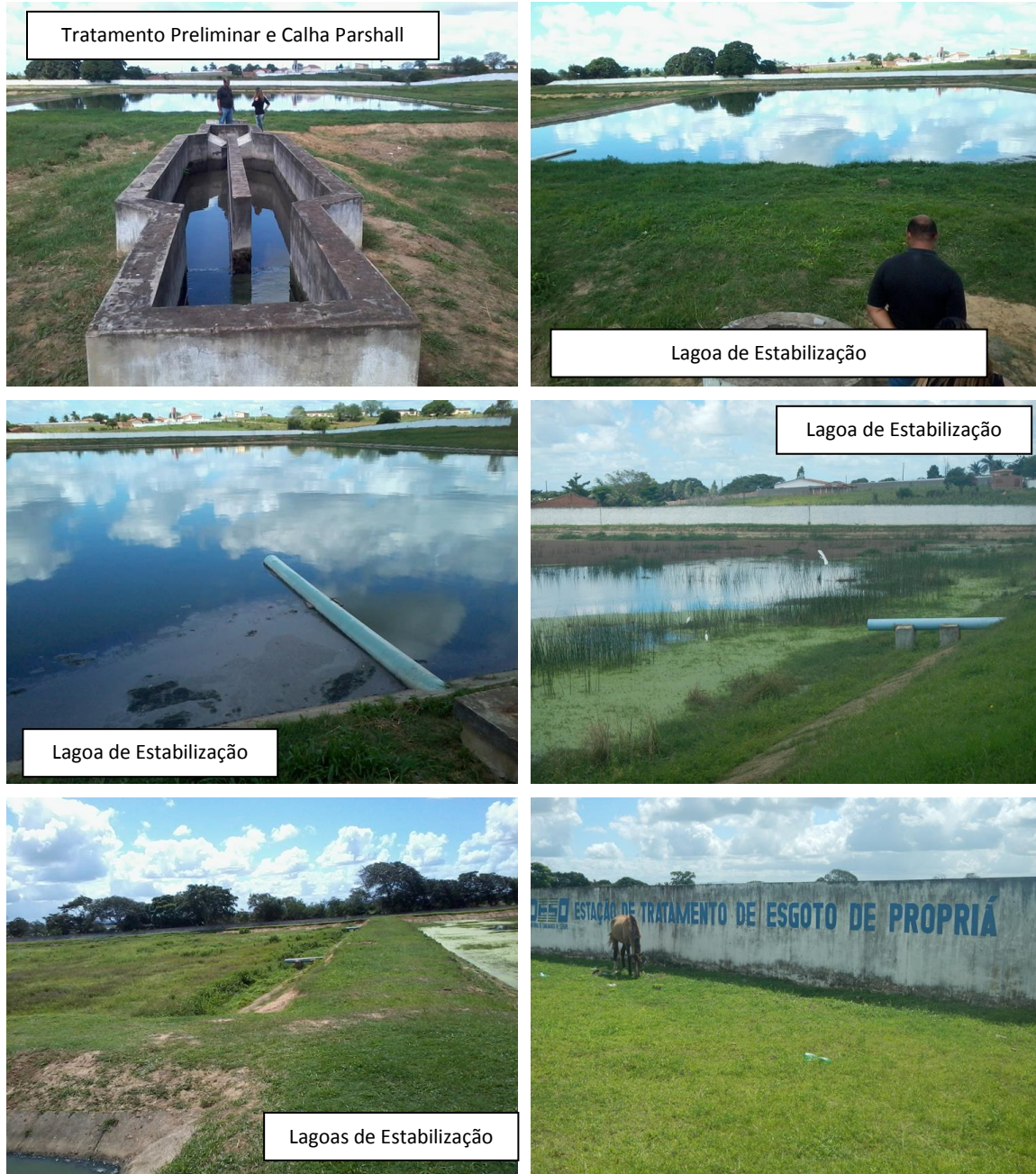
Figura 109: Estação de Tratamento de Esgoto da sede municipal Propriá. Fonte: Gesois, 2014.
