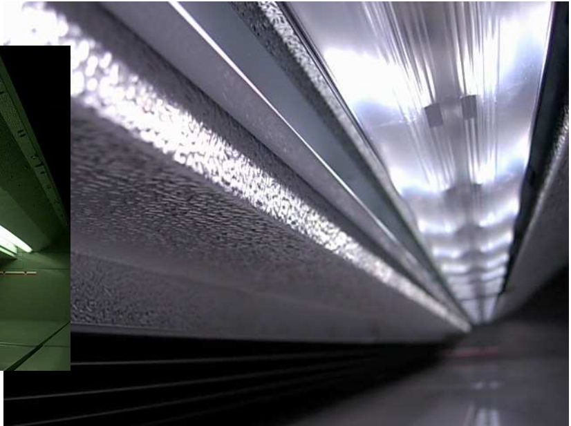
Fig 27. Iluminación sistema fluorescente y sistema de LEDs.
