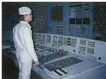
Kontrollrummet för block 3
