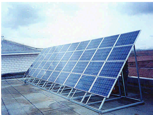
青海新能源研究所研制的屋顶太阳能系统
