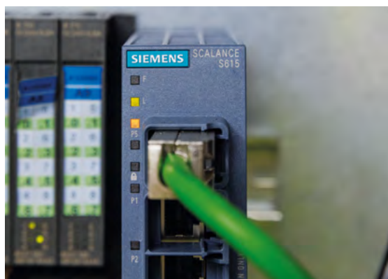
NAT router SCALANCE S615 překládá data z vnitřní sítě na vnější
