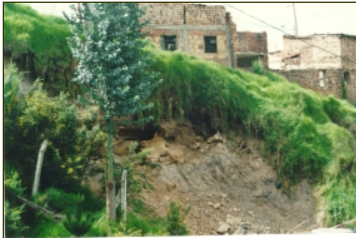
Fotografía 3.1. Afloramiento de arcillolitas y areniscas Barrio El Triángulo, se aprecia intenso fracturamiento que ha originado deslizamientos y presencia de procesos de erosión diferencial en los niveles rocosos.
