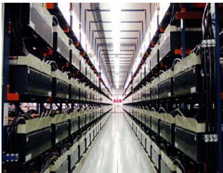
Fig. 23. Instalación de Fairbanks (Alaska) 40 MW en 7 minutos.
