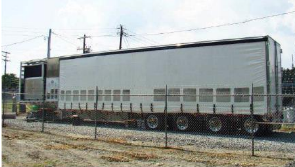
Fig. 20. Sistema transportable de baterías Zinc-bromo.
