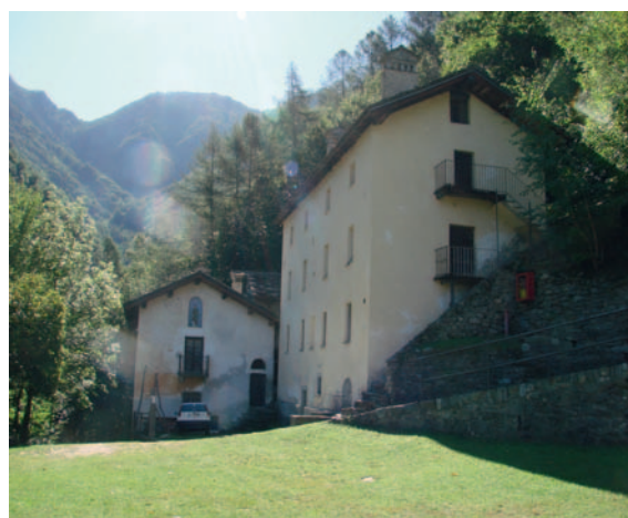
■ Gli edifici antistanti al Santuario di Machaby danneggiati dal "soffio" della valanga.
