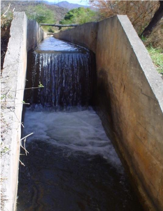
Figura 3.37. Caída Vertical, unidad de riego "Matamba", Oaxaca
