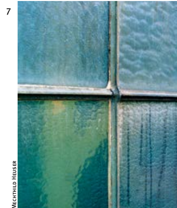
P. Behrens, AEG Turbinenfabrik dettaglio del telaio della finestra verso il cortile / detail of the window frame on the courtyard
