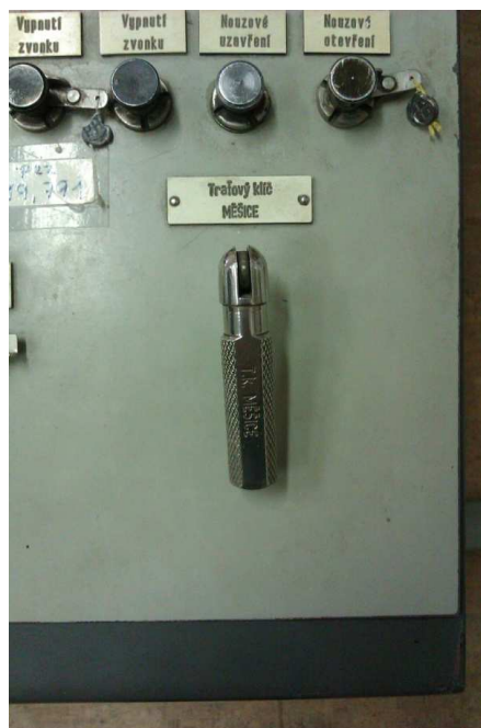
Obr. 6: Traťový klíč; Foto: autor
