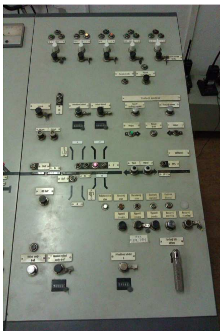
Obr. 5: Panel k ovládání AH; Foto: autor
