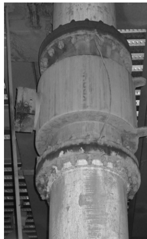
Figura 7 Medidor magnético dañado con la pulpa
