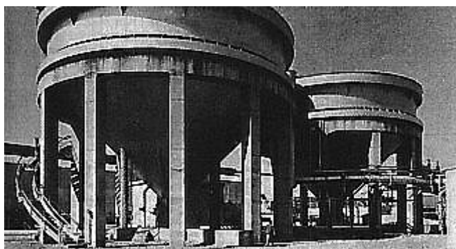
Fig. 73. - Decantadores CIRCULATOR, de 20 m de Ø, en descarbonatación
