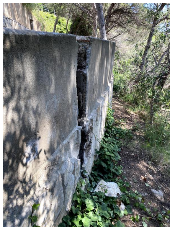
Fotografia 4: Esquerda i bolcada del mur inferior de blocs de formigó.
