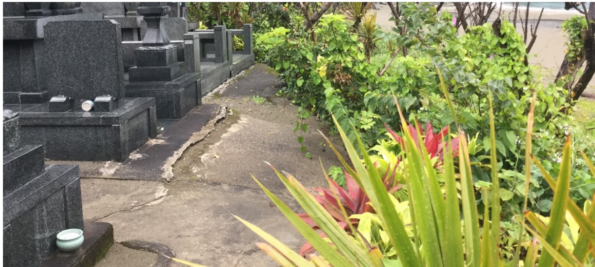
海側の通路の状態（ひび割れ状況）
