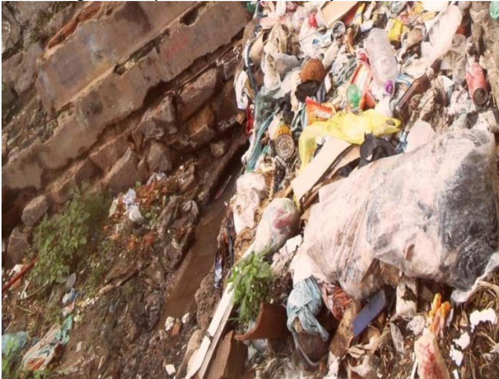
Figura 65 - Aspecto da tubulação com dejetos domésticos
