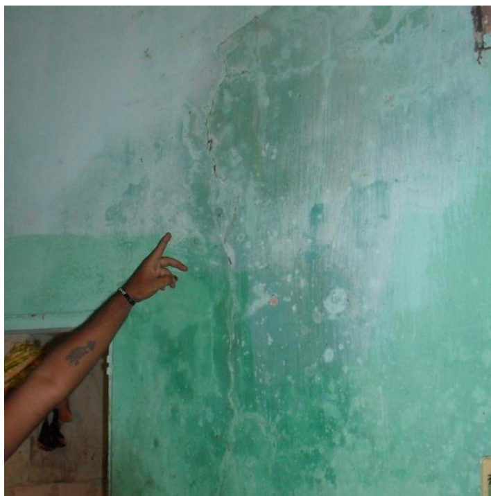
Figura 104 - Rachaduras em uma casa próxima ao porto
