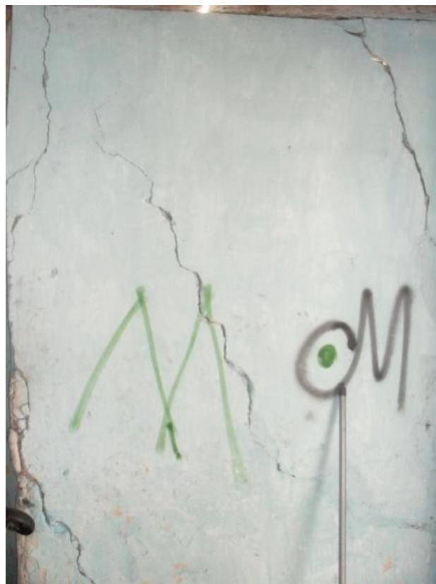
Figura 102 - Rachaduras na parede de uma casa
