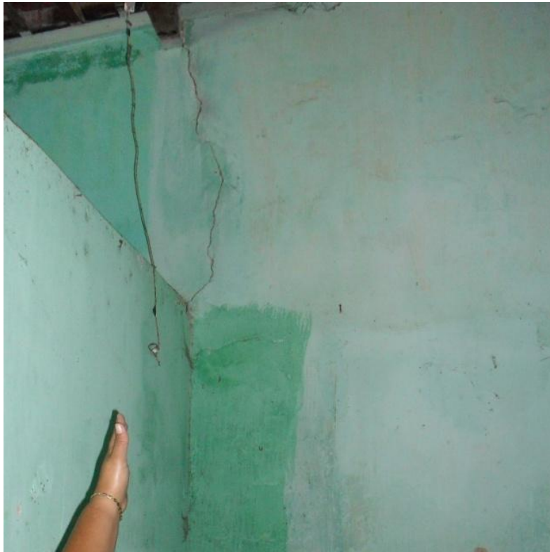
Figura 105 - Rachaduras em uma casa próxima ao porto
