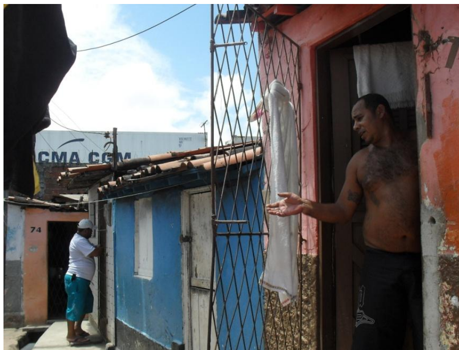
Figura 108 - Moradores argumentam que as rachaduras começaram com a movimentação de containers pelo porto
