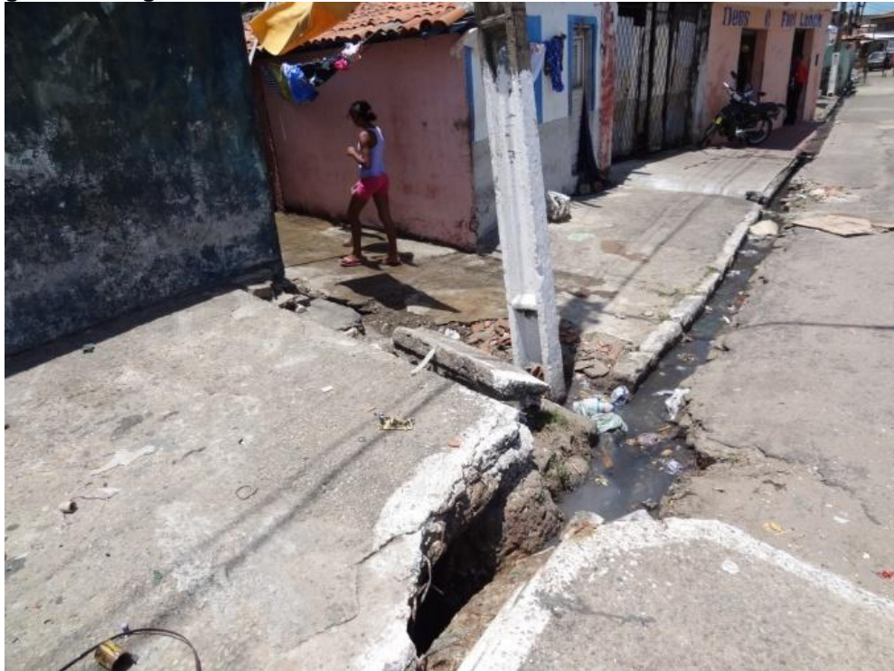
Figura 64 - Esgotamento a céu aberto na Comunidade Maruim - Estrema do Porto
