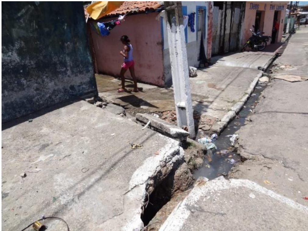
Figura 120 - Esgoto doméstico a céu aberto na comunidade do Maruim
