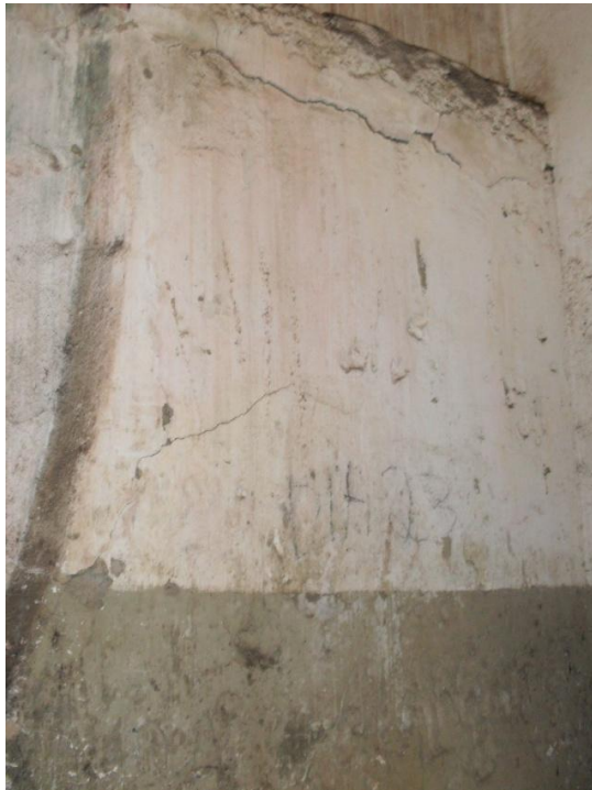
Figura 112 - Casa da moradora Maria de Fátima interdita pela Defesa Civil do município de Natal em meados de 2011
