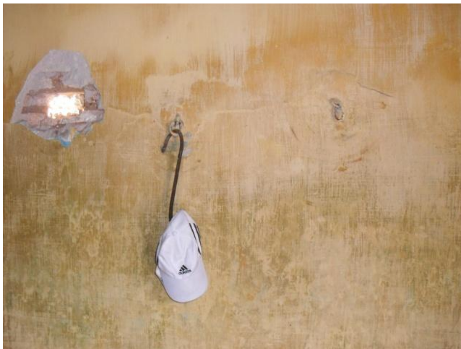
Figura 107 - Rachaduras em uma casa próxima ao porto
