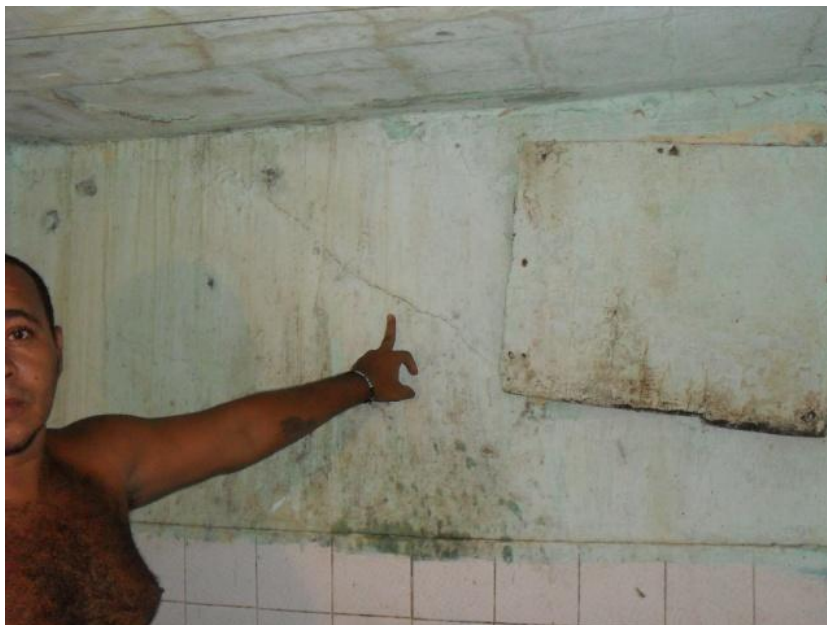
Figura 106 - Rachaduras em uma casa próxima ao porto
