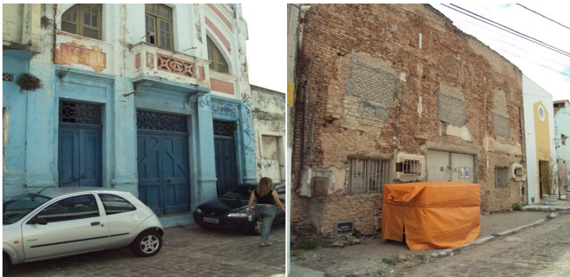
Figura 131 - Imóveis descaracterizados e em mau estado de conservação à Rua Chile
