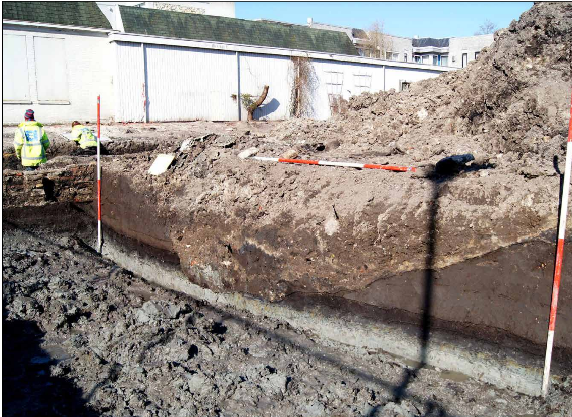
Afbeelding 10. Deze foto geeft een goed beeld van de mate van verstoring. Rigourens maar zeer lokaal. Deze verstoringen in werkput 2 zijn waarschijnlijk bij de sloop van de recente panden ontstaan. De foto is richting het noordwesten genomen.
