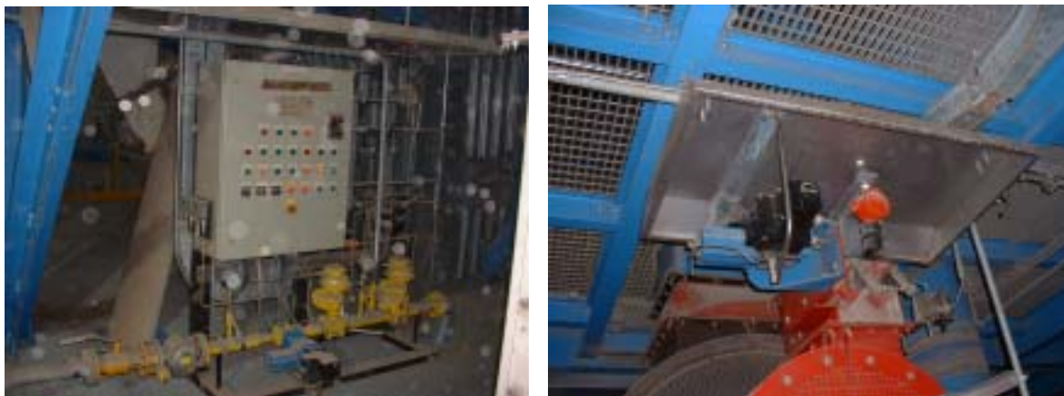
Figura 6. Dettaglio della rampa gas, del pannello locale e della cappa con il sensore rilevazione fuga gas.
