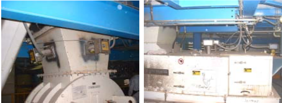
Figura 4. Dettaglio rivelatori scintille ed ugelli acqua nebulizzata installati nel sistema di alimentazione RDF.
