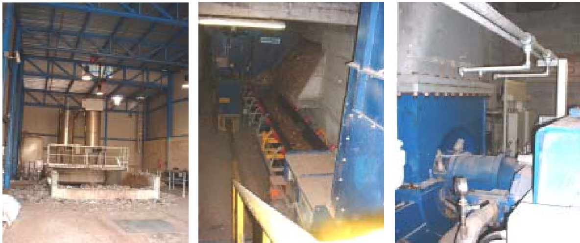
Figura 3. a) Conferimento RDF; b) Nastro di trasferimento RDF alla caldaia; c) Dettaglio cuscinetti turbina.
