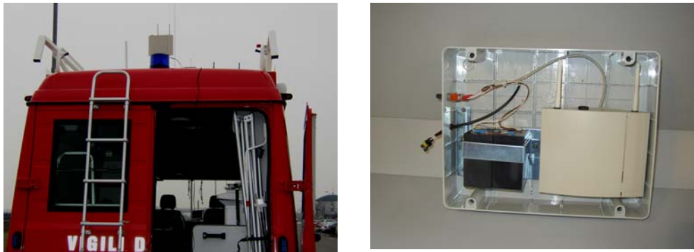
Figura 10 stazione dect remota
