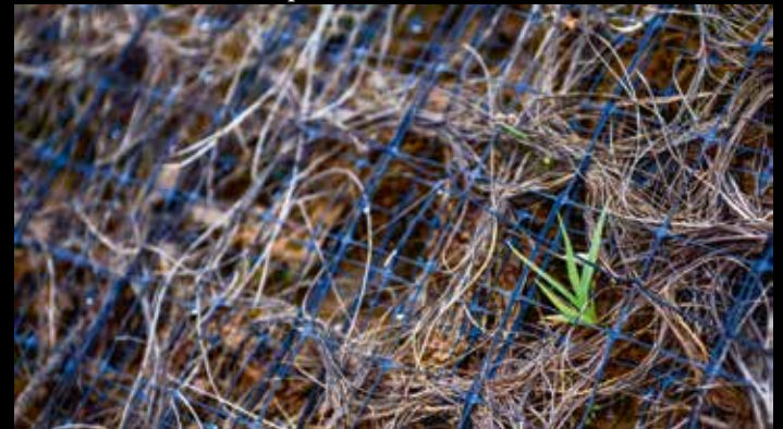
▼ Grid to prevent soil erosion in the slope | Grilla para prevenir la erosión del suelo en la pendiente
