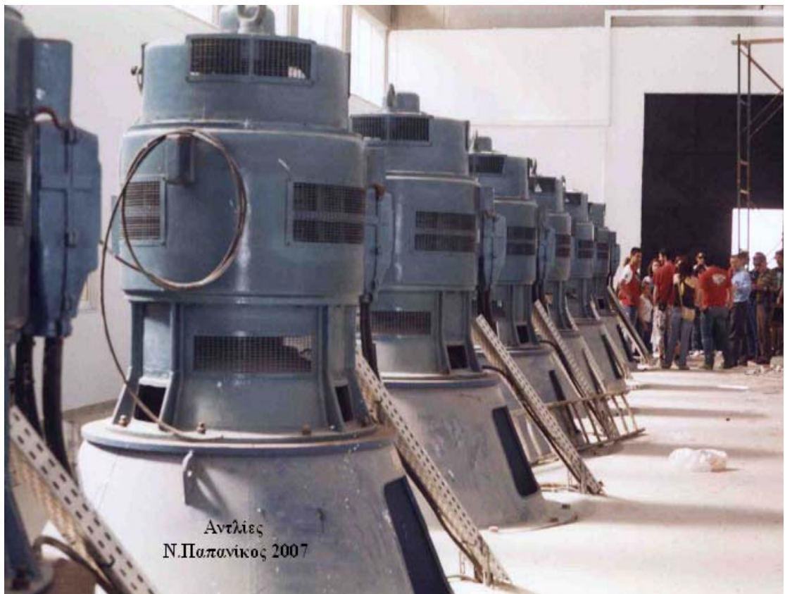
Εικόνα 70. Αντλίες στα Αντλιοστάσια Κόμβου Πέτρας
