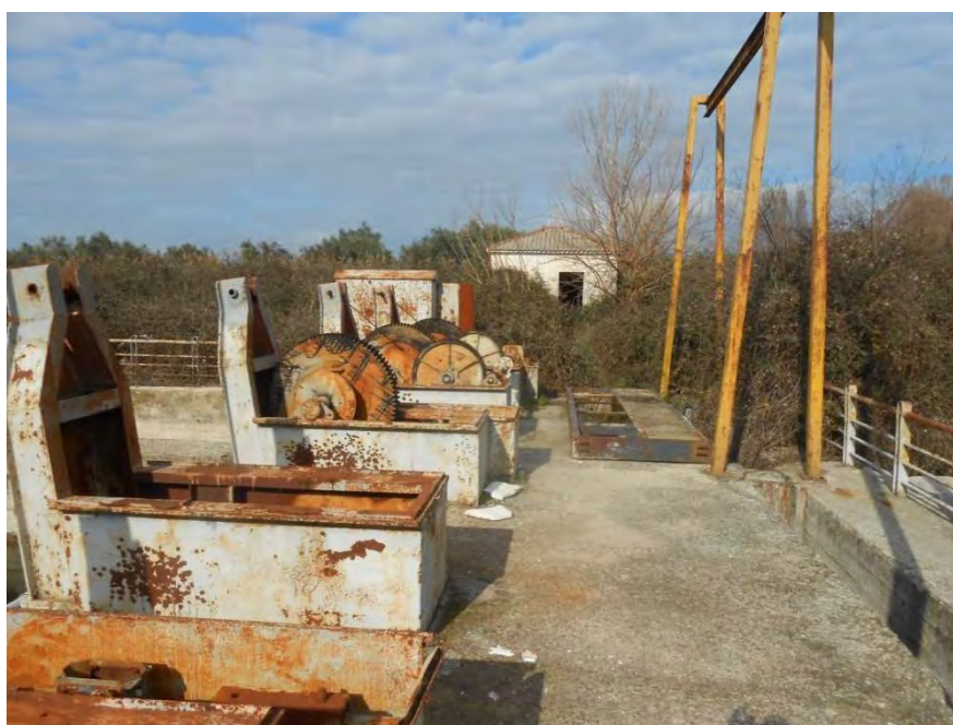
Εικόνα 14: Βανδαλισμοί στο μηχανικό εξοπλισμό του θυροφράγματος
